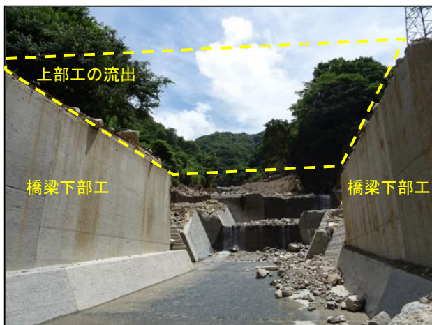
【写真①】被災状況[H30.7.13撮影]
