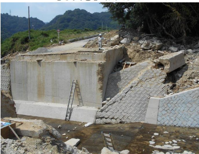
【写真①】被災状況
