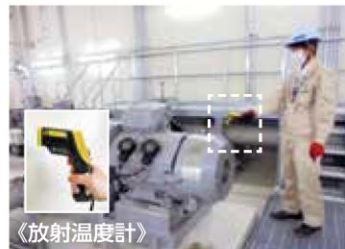
▲ポンプの点検
