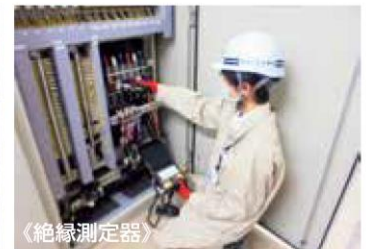
▲電気設備の点検
