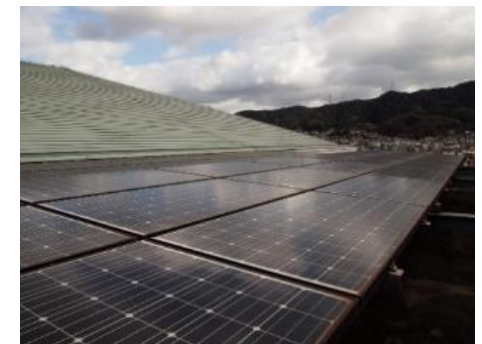
市役所屋上太陽光パネル
