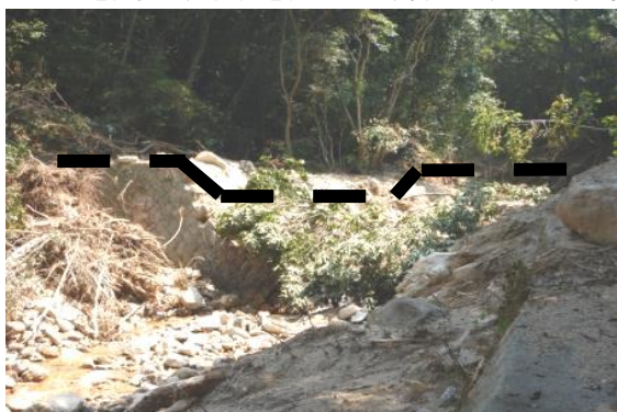
土石流を捕捉し，被害を軽減した砂防えん堤（一部破損）
