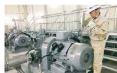
配水池やポンプ所などの保守点検を定期的に行っています。【ポンプモーターへのグリス注入】
