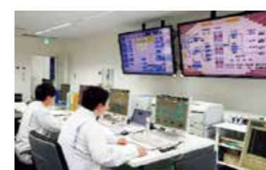
24時間365日体制で、配水池の水位やポンプ所の運転状況を監視しています。【宮原浄水場 中央監視室】
