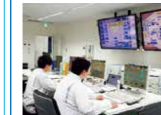
365日24時間体制で、配水池の水位やポンプ所の運転状況を監視しています。 〔宮原浄水場 中央監視室〕
