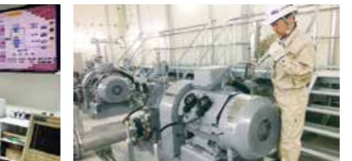
配水池やポンプ所などの施設の点検保守を定期的に行っています。 〔ポンプモーターへのグリス注入〕
