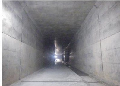
▲雨水を溜める地下貯留施設 【広東地区雨水貯留施設の内部】 (幅・高さ:6.5m、長さ:106m)
